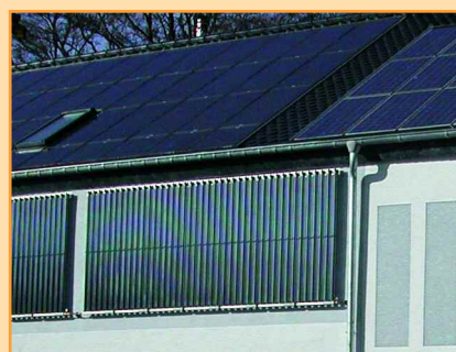
Installation TUBO sur façade combinée au photovoltaïque, Luxembourg
